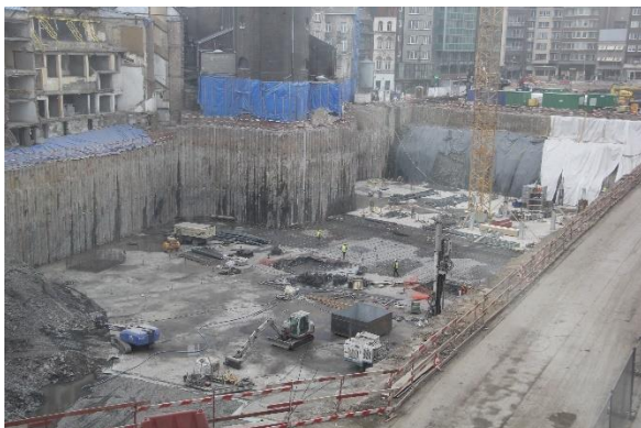
Parking onder de Place Verte 2015
